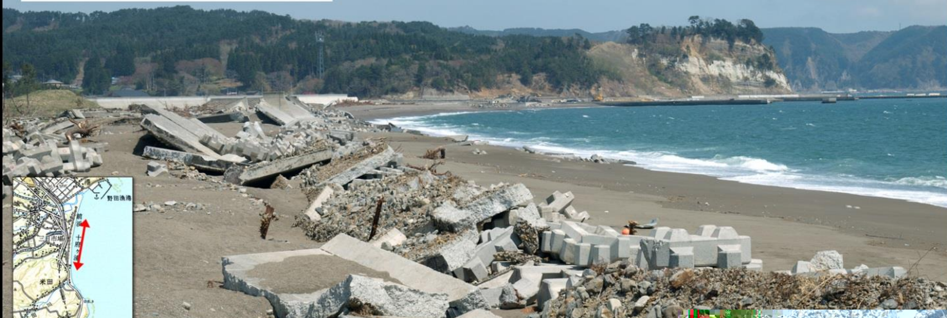
破壊された防潮堤（林野庁所管／TP+10.3m、一部+12m）
