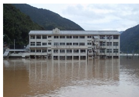
H26. 8 避難所2階の浸水 (徳島県)
