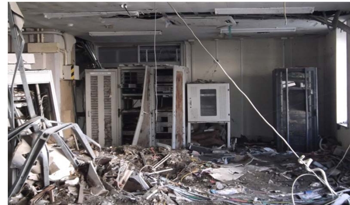
（被災したサーバ室 陸前高田市提供写真）
