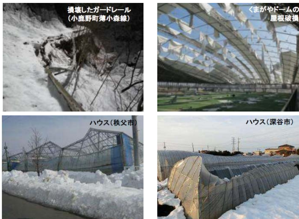
図 埼玉県における被害状況写真
