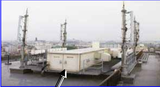
屋上基地局の蓄電池の写真
