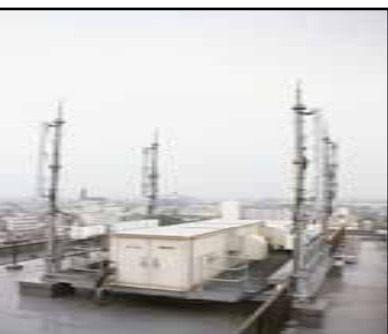
屋上設置基地局
