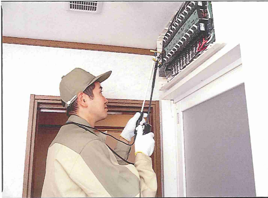
分電盤で、絶縁抵抗の測定
