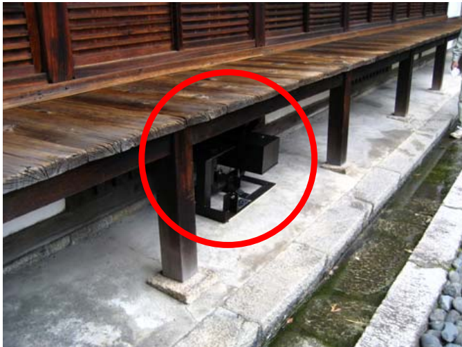
縁下に設置した放水銃(本願寺)
