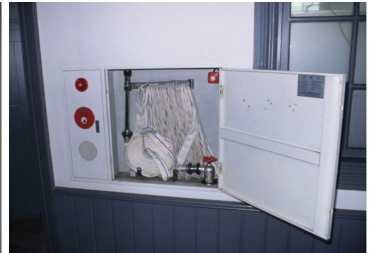
壁埋込式屋内消火栓 (旧福島県尋常中学校本館)
