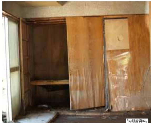
ドア等の面材が膨張し剥離している
