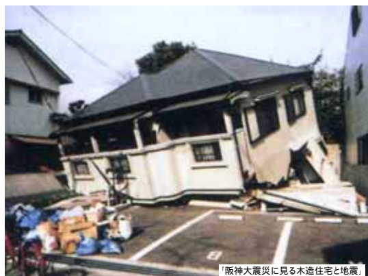
一見して住家全部が倒壊している例
