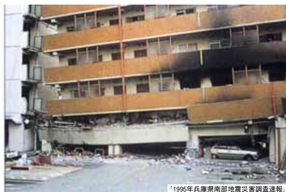
一見して住家の一部の階が全部倒壊している例
