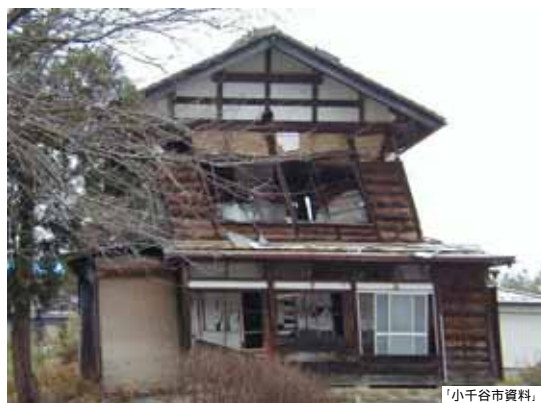
一見して住家の一部の階が全部倒壊している例
