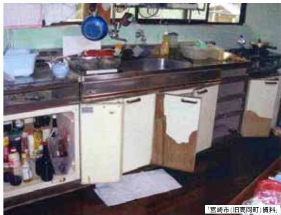
台所の流し台:汚損し、配管が詰まっている
