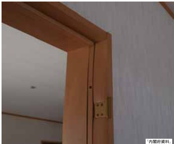
建具が歪み、開閉が不能になっている
