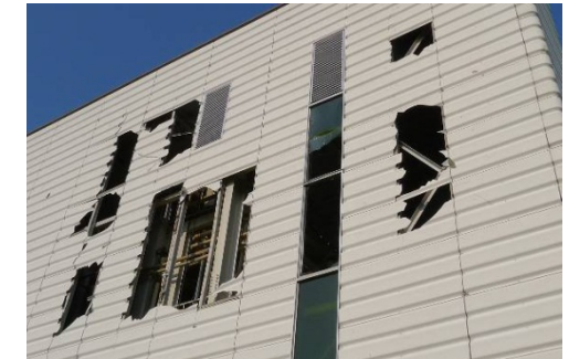
外壁材とガラスの損傷
