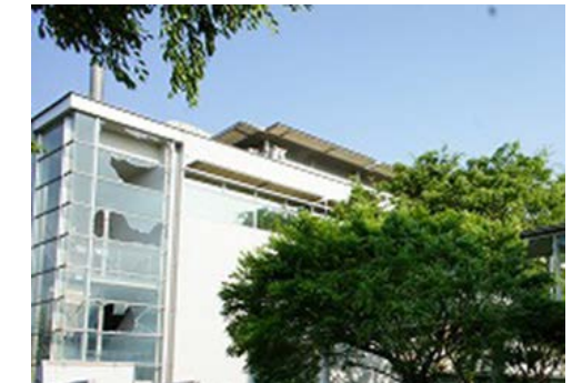
ガラスの損傷
