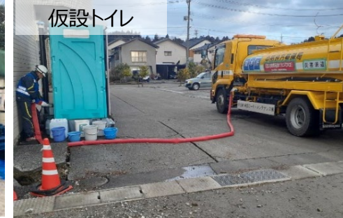
仮設トイレ 輪島市内 仮設トイレ約270基
