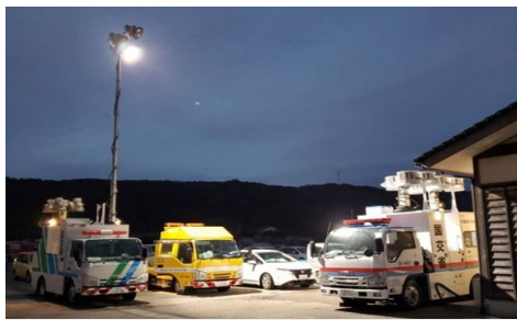
避難所への外部照明提供 (輪島市 道下集会所)
