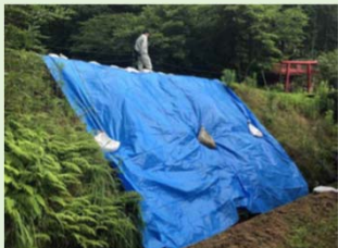
防災重点ため池堤体の一部損傷
