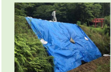
防災重点ため池堤体の一部損傷
