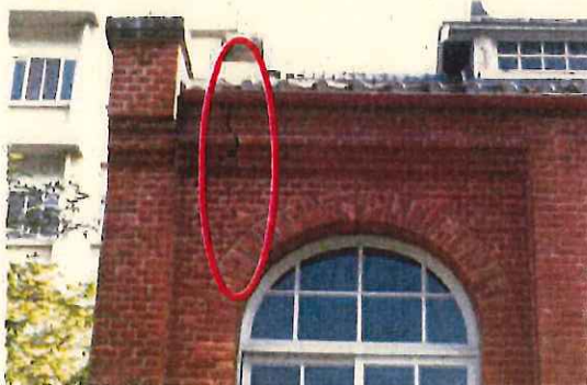
外壁と内壁が剥離、余震ではがれる状態
