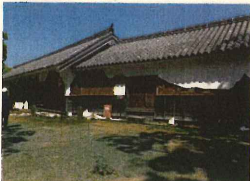
重要文化財の櫓の損傷例
