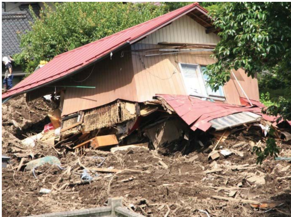
【一見して住家がすべて倒壊している場合】
