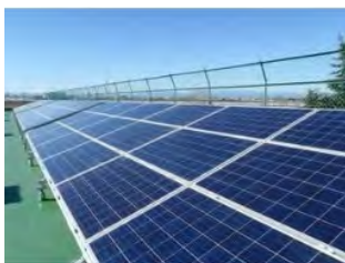
太陽光パネル
