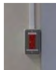
非常用コンセント
