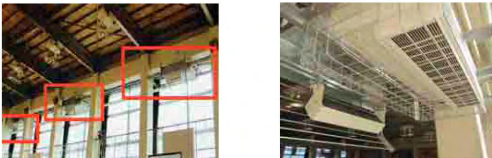
図表 9 体育館のエアコン設置例
