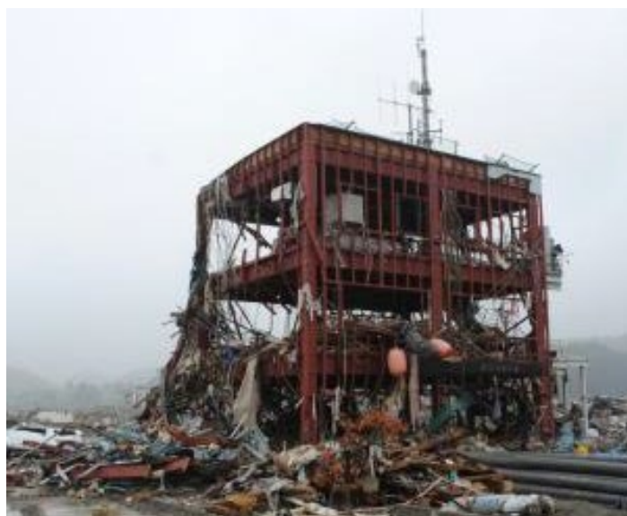
防災対策庁舎の被害状況
