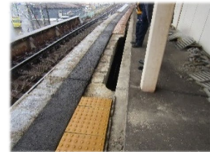
【被災した鉄道施設】
