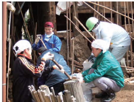
崩れた土蔵の片付けをしている様子（石川県輪島市） 写真提供：黒澤司
