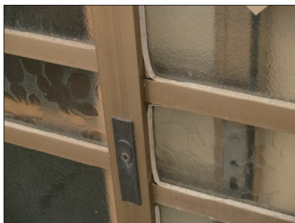
9704 【アルミサッシ】 鍵の破損や、ビードのはずれが見られる。あるいは開閉が不能になっている。
