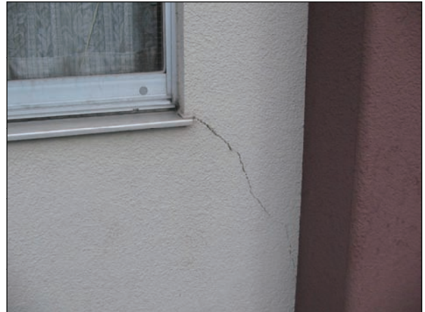
【鉄筋コンクリート造】 8302 近寄らないと見えにくい程度のひび割れ(幅約0.2mm以下)が生じている。
