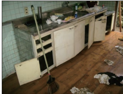
(台所の流し台：汚損し、配管が詰まっている。) 5305
