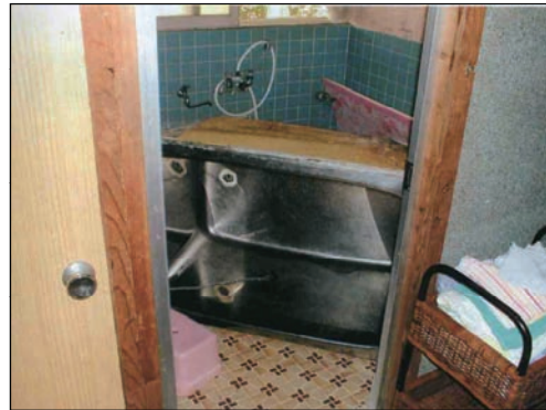
(浴槽：転倒し、配管が切れている。)
