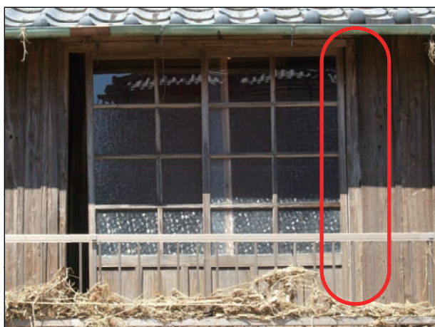
4903 【木製サッシ】 壁面との間に隙間が生じている。
