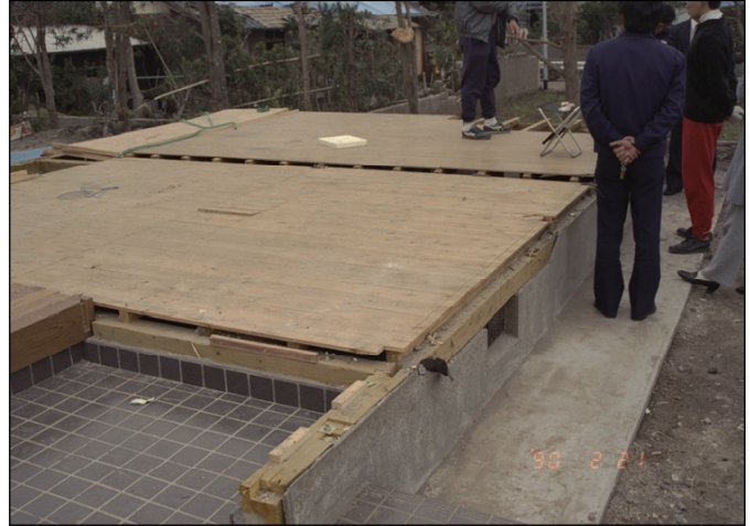
屋根や外壁、床が吹き飛ばされ、床下地、土台などが残る。基礎に被害は見られない。 5701
