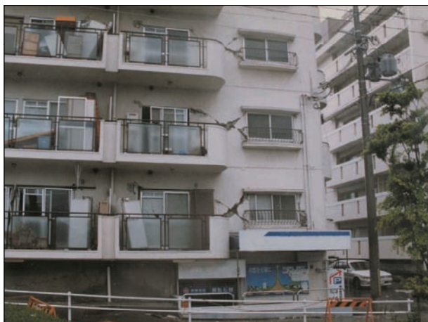
【鉄筋コンクリート造】 8403 鉄筋が大きく露出しており、鉄筋の曲がり・破断が見られる。大きなひび割れが生じ、内部のコンクリートも崩れ落ち、壁の向こうが透けて見える。
