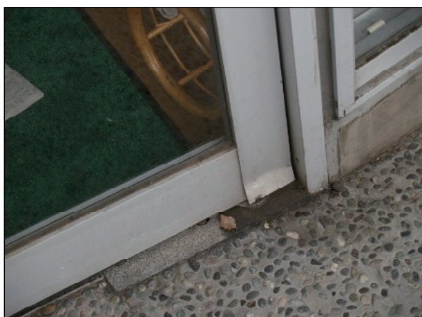
9703 【ドア】 変形が見られ、取り付け部がはずれている。
