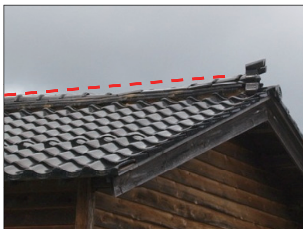
1504 棟瓦のずれ、破損、落下が著しいが、その他の瓦の破損は少ない。
