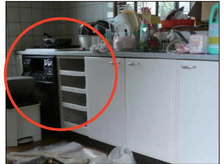
(システムキッチンのコンロ類が浸水により故障して使用不可能になっている。) 5306
