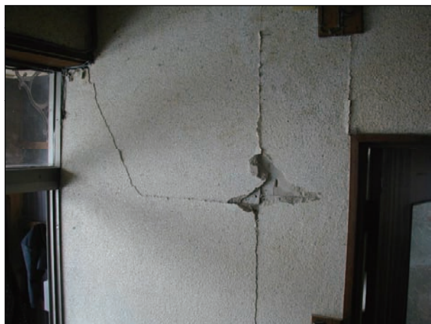
【内部仕上】 クロスが破れている。
