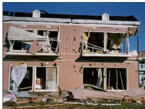
(ベランダ：手摺が破損している。)
