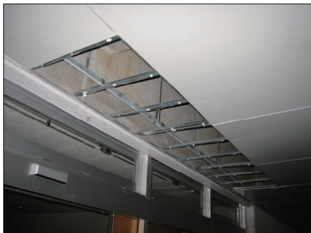
【天井】 9604 天井板が脱落している。
