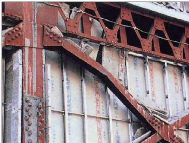
【鉄骨造】 8303 座屈変形が見られる。
