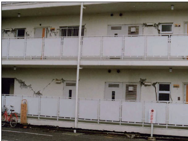
【鉄筋コンクリート造】 8401 大きなひび割れ(2mmを超える)が多数生じ、コンクリートの剥落も激しい。鉄筋が露出しているものの鉄筋の変形は見られない。
