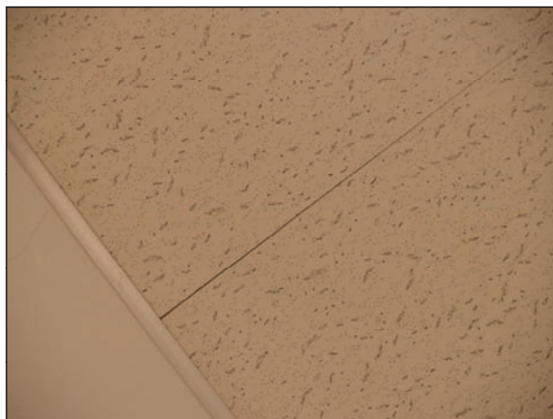
【天井】 天井板にわずかな隙間が生じている。
