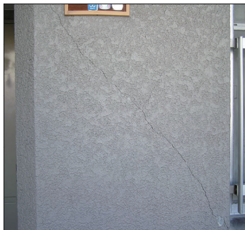
【雑壁】 9302 一部にひび割れ(幅約0.2mm~1mm)やはがれが生じている。
