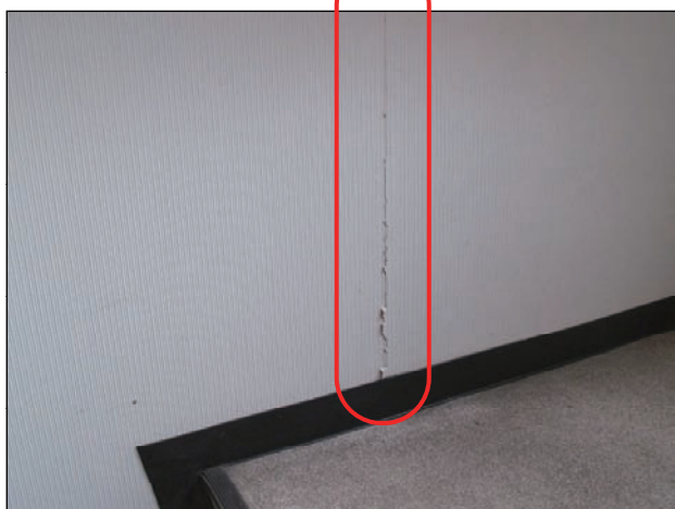
【内部仕上】 ボードの目地部にひび割れやずれが生じている。
