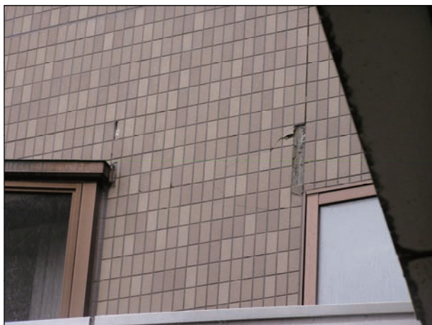
【外部仕上】 9301 仕上材のわずかな剥離、目地のずれが見られる。
