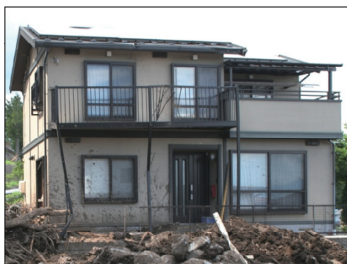
(ベランダ：外力等により変形している。)
