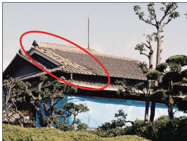
1506 棟瓦以外の瓦もずれが著しい。
