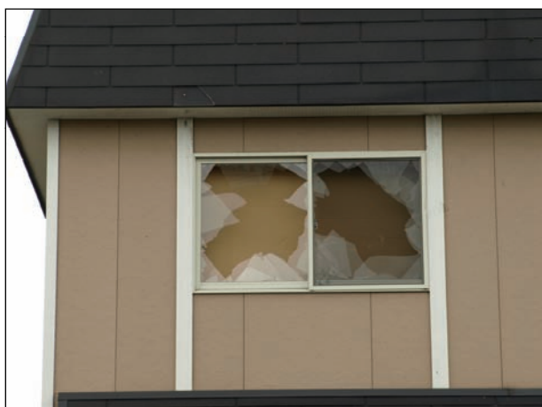
9705 【アルミサッシ】 ガラスが破損している。
