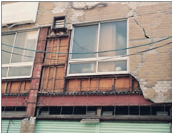
【外部仕上】 9403 全面にわたる大きな亀裂が見られ、面外への大きなはらみ出し、大きな剥落が見られる。
