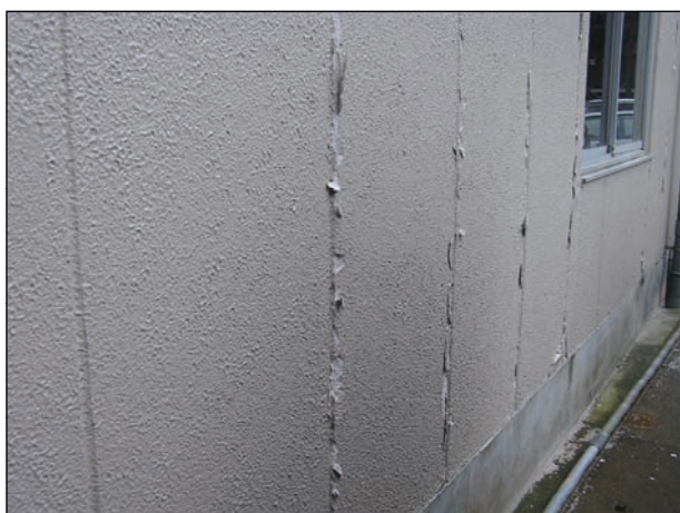
【外部仕上】 9303 仕上やパネルの目地にはっきりとしたひび割れが見られる。仕上材が部分的に剥離している。
