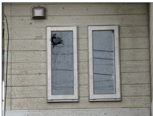
9706 【アルミサッシ】 ガラスが破損している。
