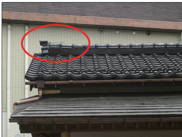
1501 棟瓦(がんぶり瓦、のし瓦)の一部がずれ、破損が生じている。
