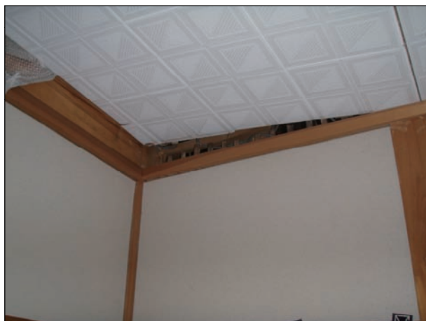
【天井】 天井板の浮きが生じている。
