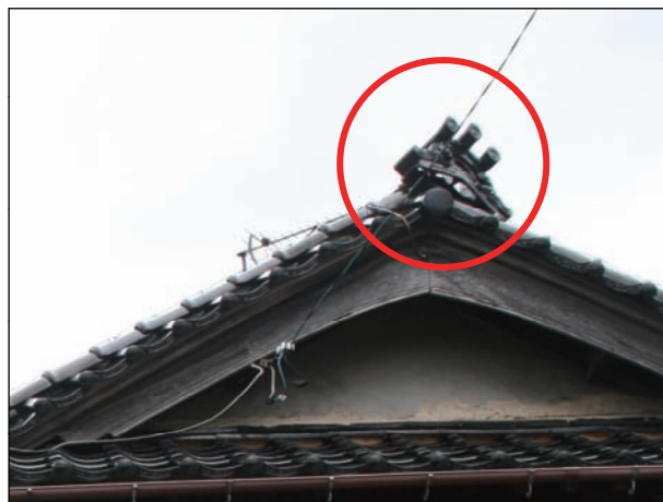
1502 棟瓦(がんぶり瓦、のし瓦)の一部がずれ、破損が生じている。
