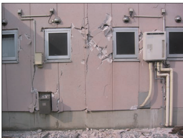
【外部仕上】 9305 大きなひび割れ又は仕上の剥離が見られる。
