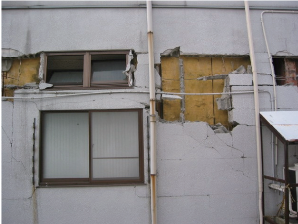
【外部仕上】 9401 仕上材の破壊、崩落が一部見られる。
