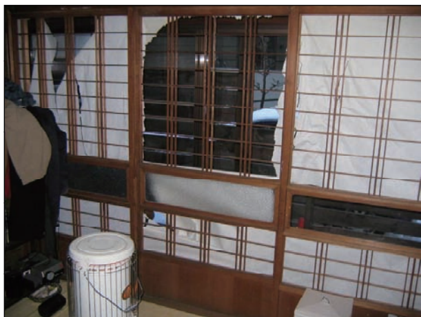
9701 【襖・障子】 家具の倒れ込み等によって襖紙、障子紙が破損し、張り替えが必要である。
