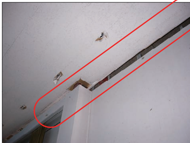
【天井】 9602 天井板のずれが見られる。
