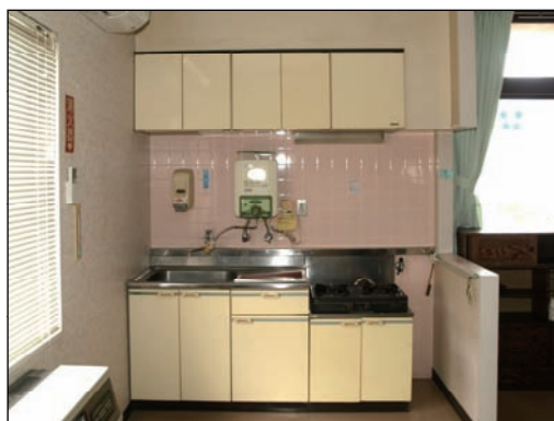
(台所の流し台：配管が破損し水やガスが使えない。)
