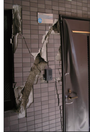
【雑壁】 9402 全体にひび割れ(幅約1mm~5mm)やはがれが生じている。
