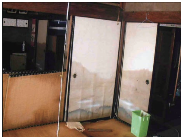
4902 【障子・襖】 浸水による襖・障子・ドアの破損(表面、格子・縁の洗浄、張り替えによって、再使用が可能な程度)
