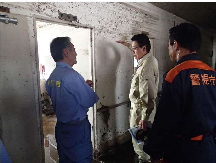
介護老人保健施設被害状況調査 【岩泉町内】
