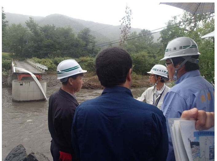
町道橋落橋現場状況調査 【遠軽町内】
