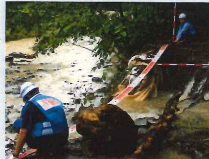
占冠村現地調査(村道流出)
