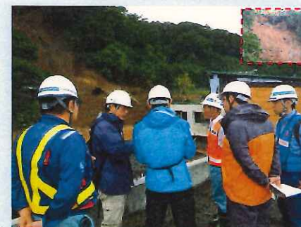
羅臼町土砂崩れ現場
