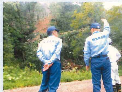
白糠町現地調査(法面崩落)
