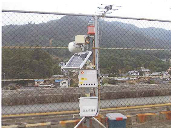
国土交通省による土石流センサー警報装置の設置状況(広島市立梅林小学校屋上に設置)
