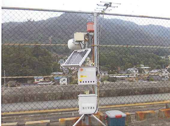
国土交通省による土石流センサー警報装置の設置状況(広島市立梅林小学校屋上に設置)
