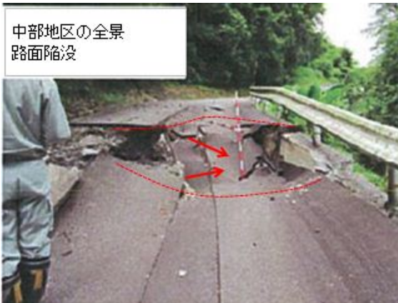
《参考・高知県提供》地すべりによる路面陥没 【高知県大豊町】
