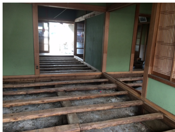
浸水被害を受けた住宅 【徳島県那賀町鷲敷地区】
