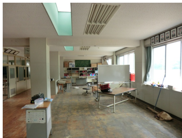
被害を受けた中学校校舎の様子 【徳島県阿南市加茂谷地区】
