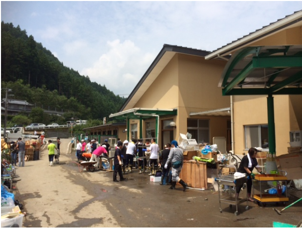
浸水被害を受けた社会福祉施設の復旧作業の様子 【徳島県那賀町相生地区】
