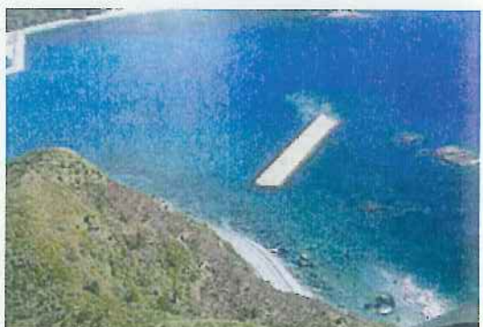
阿嘉漁港防波堤破損箇所空撮【沖縄県島尻郡座間味村】
