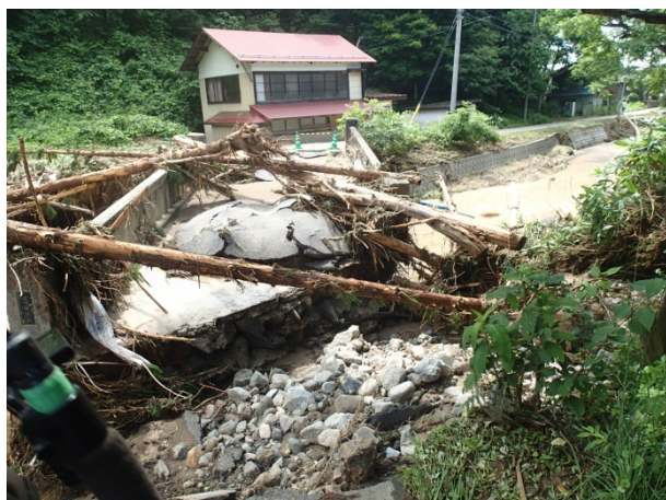
織機川溢水による被害状況 【南陽市漆山四谷地区】
