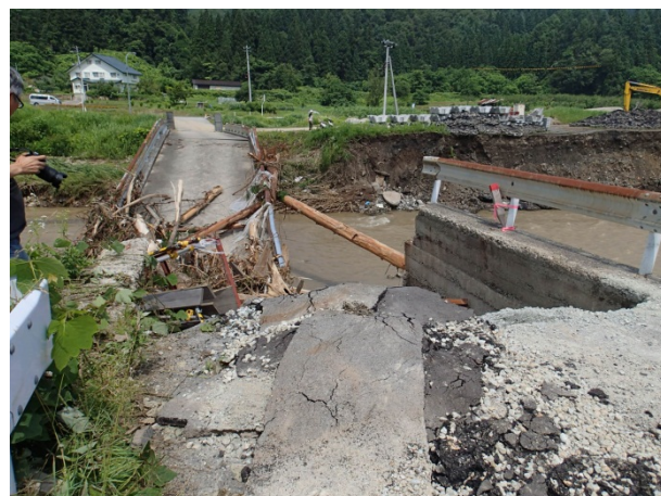
崩壊した橋梁の様子 【南陽市白山在家地区】
