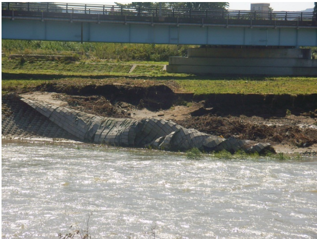
被害を受けた馬淵川の護岸 【三戸郡南部町門前地区】
