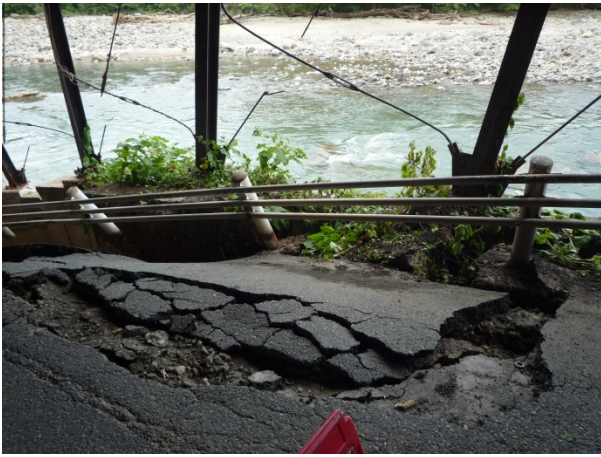
玉川の増水により洗掘被害を受けた国道 341号線【仙北市田沢湖玉川地区】
