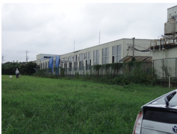
工場被害の状況②（渡辺産業） 【栃木県鹿沼市極瀬地区】
