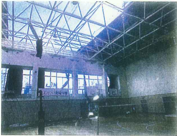
中学校体育館の被害の様子 【埼玉県越谷市大松地区】
