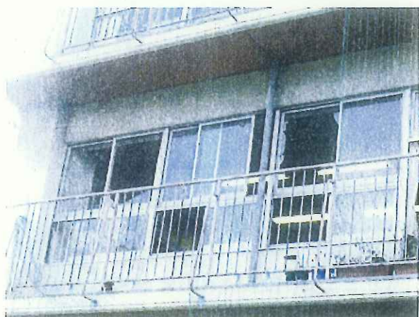
小学校校舎の被害の様子 【埼玉県越谷市下間久里地区】
