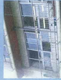
小学校の被害の様子
