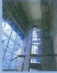
中学校体育館の 被害の様子
