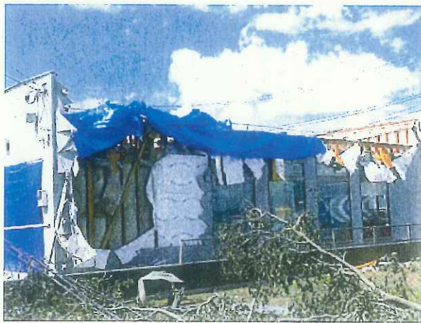
住宅街の被害の様子④ まつぶしまちおおかわど 【埼玉県松伏町大川戸地区】
