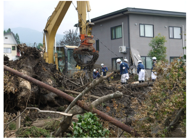
土石流による被害の様子③【同】
