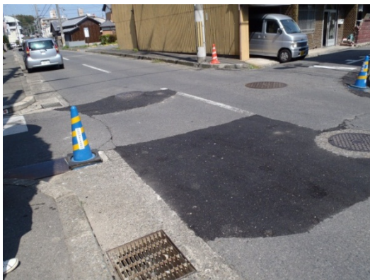
路面隆起後の仮復旧状況を調査【淡路市内】
