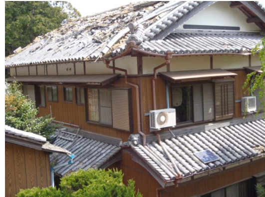
市街地の住家の被災状況を調査 【洲本市内（下内膳地区）】
