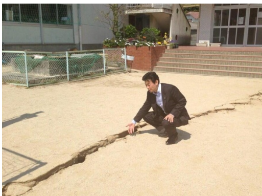
グラウンドの亀裂を調査【洲本第一小学校】
