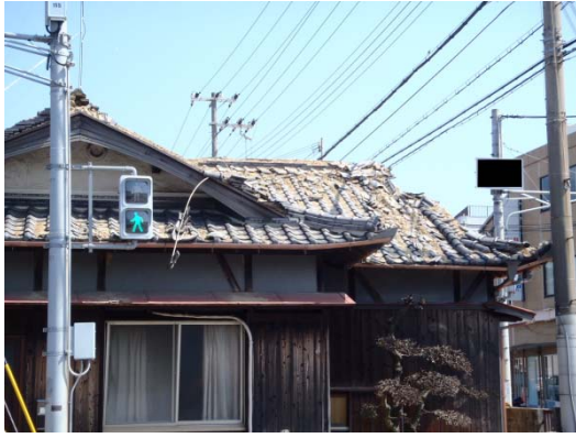
市街地の住家の被災状況を調査【淡路市内】
