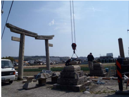
鳥居の一部崩落状況を調査【洲本市内】
