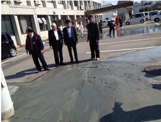
知事とともに液状化状況を調査【淡路市内】
