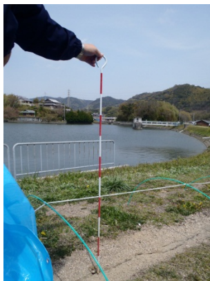
ため池の堤体天端の亀裂を調査【淡路市三宅谷池】
