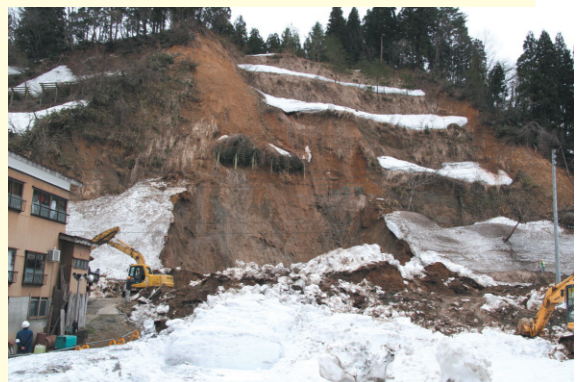
■新潟県十日町市田麦地内で、4月12日に発生した土砂崩れ(気温の急上昇に伴う雪解けが土砂災害を誘発)→4月17日通行規制解除
