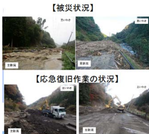
図 被災状況及び応急復旧作業の状況
