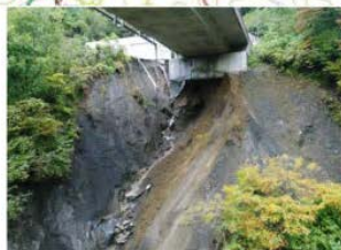
▲土砂崩落状況(橋梁下方より撮影)
