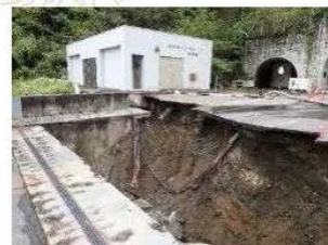
▲橋台背面土砂崩落状況
