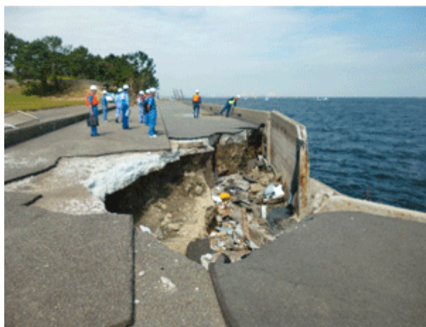
図 横浜市金沢地区 護岸の被災状況
