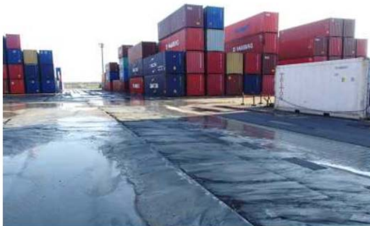
コンテナヤードの液状化
