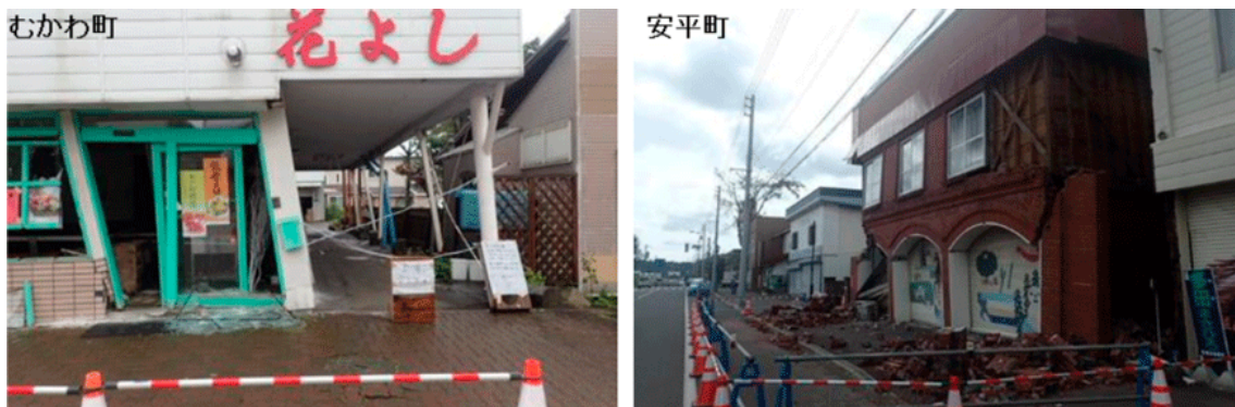
商店街等の家屋被害（むかわ町、安平町（あびらちょう））
