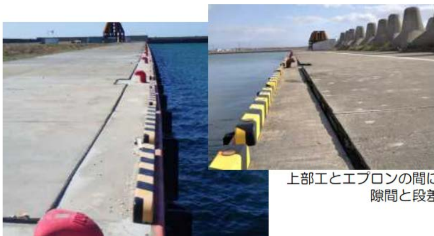
係留施設の法線変位
