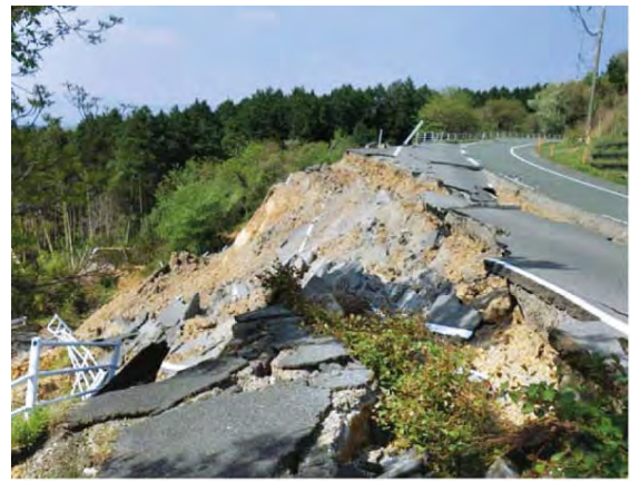
路肩の崩壊 (西原村小森)
