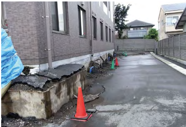
液状化による宅地被害 (熊本市西区近見地区)
