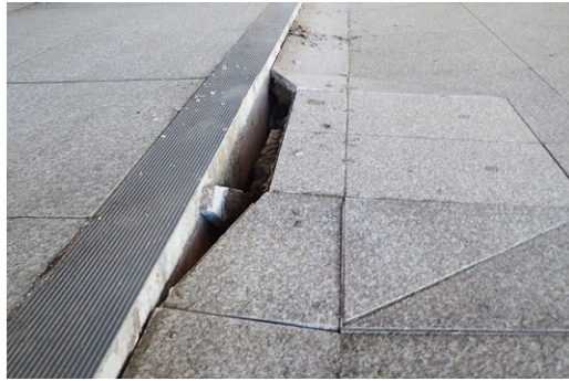
路面のひび割れ（福島県相馬市）
