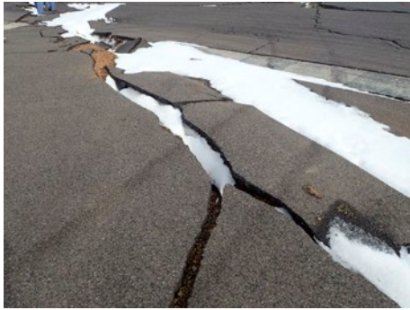
路面のひび割れ（福島県二本松市）
