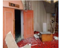
【被災したホテル館内】
