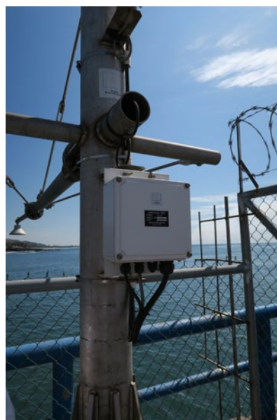
日本製の潮位計測システムが導入された港（エルサルバドル）写真提供：JICA
