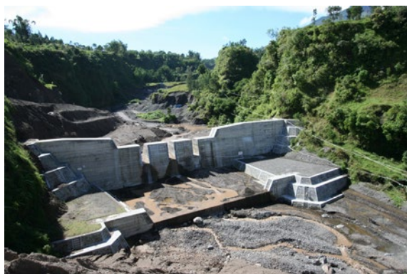
日本の技術を活用した砂防施設整備（インドネシア） 写真提供：JICA
