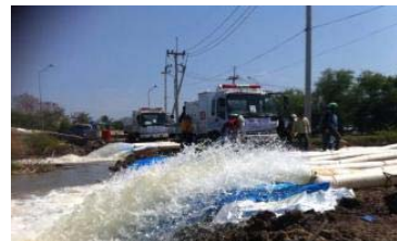
排水ポンプ車
